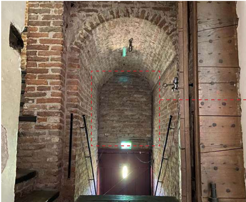
ruimte boven de toegangsdeur geeft mogelijkheid om de deur te verhogen
